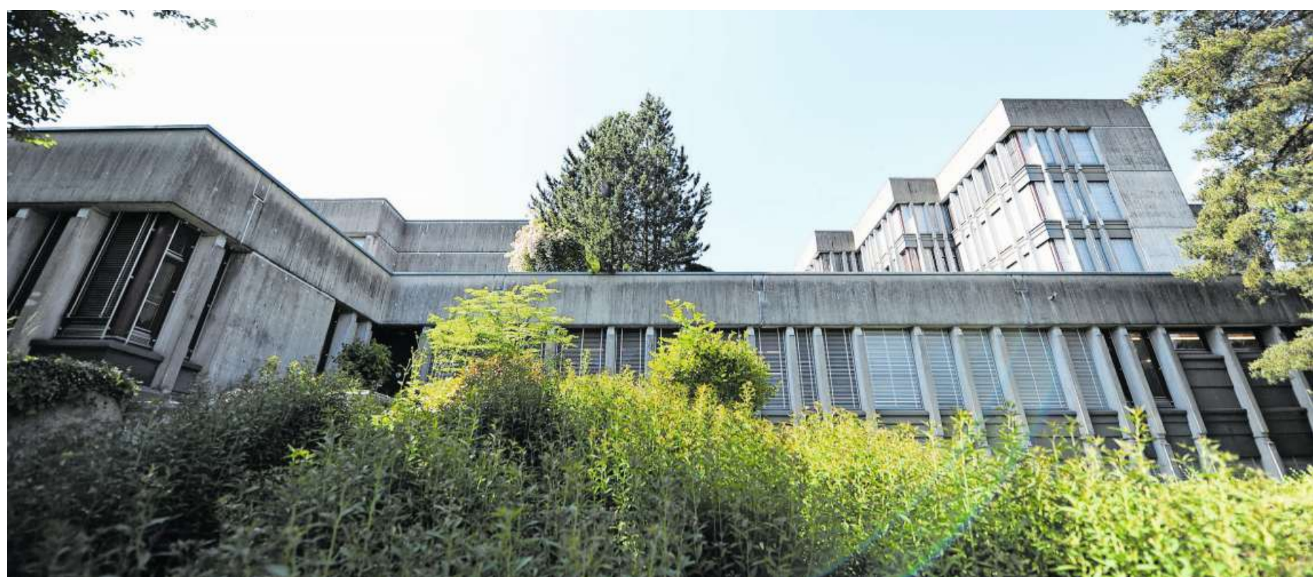
Die Gebäude der Kantonsschule in Wattwil sind möglicherweise schutzwürdig. Sicher sind sie aber sanierungsbedürftig, was sich zum Beispiel im Innern zeigt.
